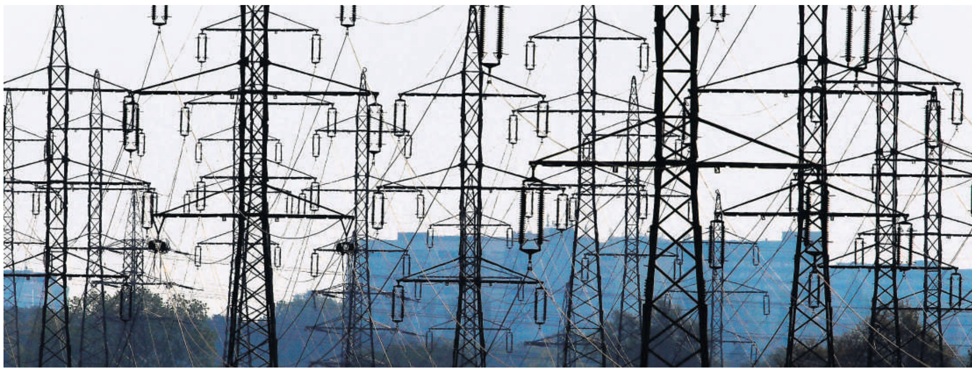
Das Leitungswirrwarr steht stellvertretend für die komplizierten Verhandlungen, in denen die Kommunen beim Rückkauf ihres Stromnetzes gerade stecken.
